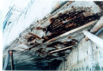
塩害を受けた栈橋構造物の一例
