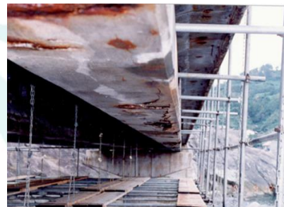
塩害を受けた橋梁構造物の一例
