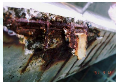
塩害を受けた橋梁構造物の一例
