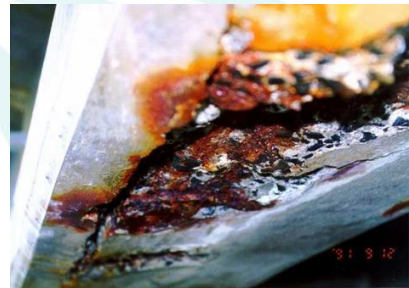
塩害を受けた橋梁の一例
