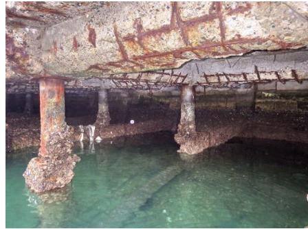
栈橋の剥離・鉄筋露出状況の例
