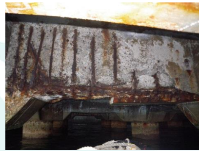
塩害を受けた構造物の一例
