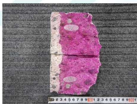
写真-2 中性化状況(割裂面の場合)
