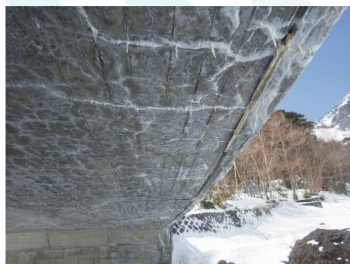
凍害（ひび割れ）
