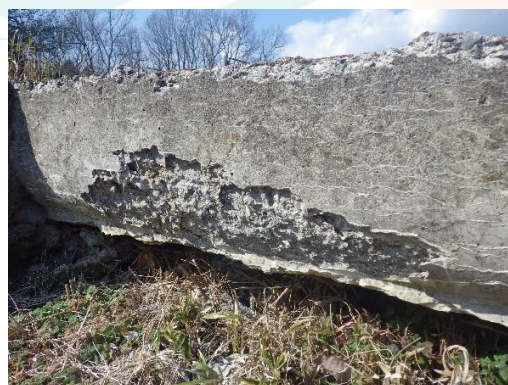
凍害（スケーリング）
