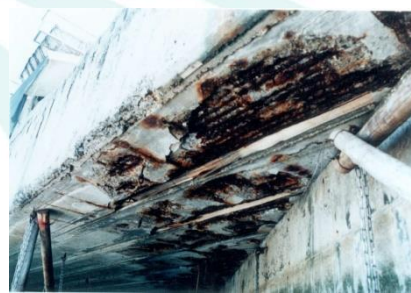
塩害を受けた栈橋構造物の一例
