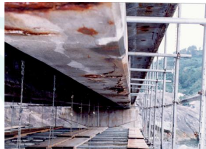
塩害を受けた橋梁構造物の一例
