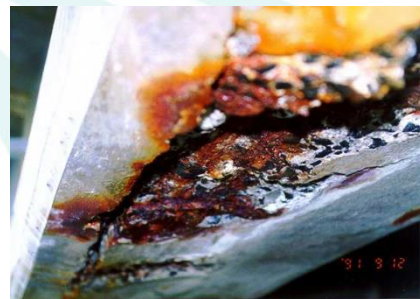
塩害を受けた橋梁の一例
