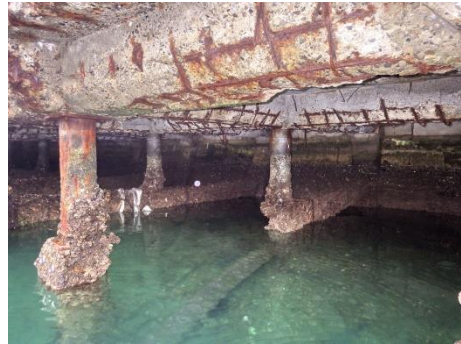
栈橋の剥離・鉄筋露出状況の例
