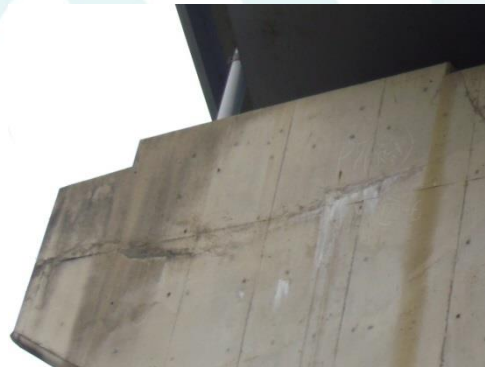
不適当な打ち継ぎに起因すると思われるひび割れの例
