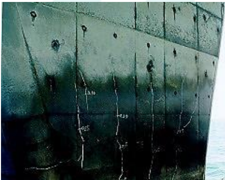
温度応力に起因すると思われるひび割れの例
