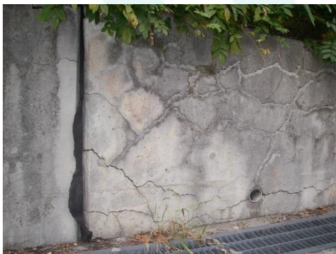
ASRに起因すると思われるひび割れの例
