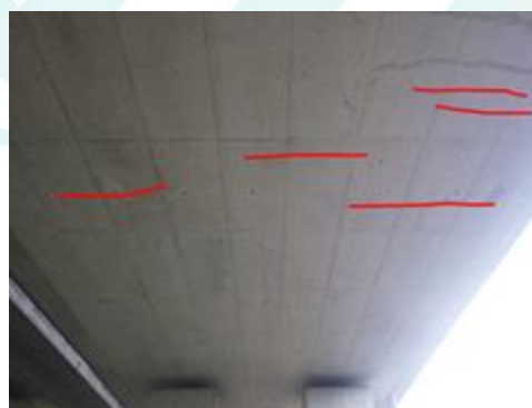
RC中空床版における曲げひび割れの例
