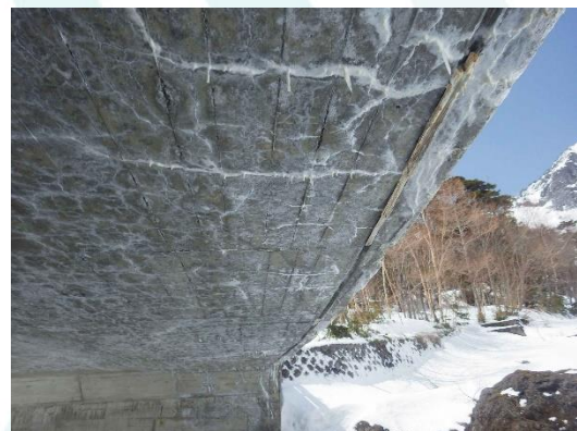
凍害（ひび割れ）
