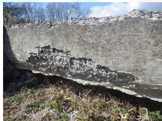
凍害（スケーリング）
