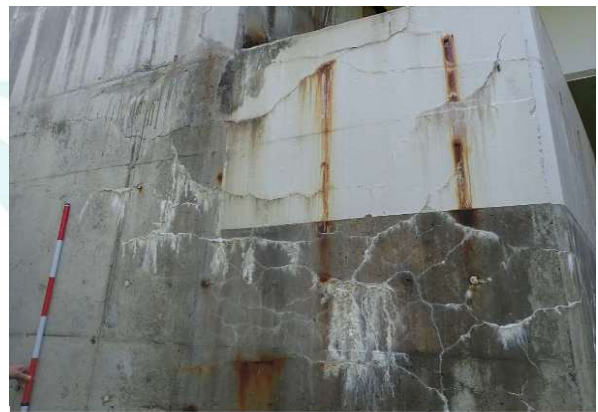
写真-1 ASRによる損傷（亀甲状のひびわれ）
